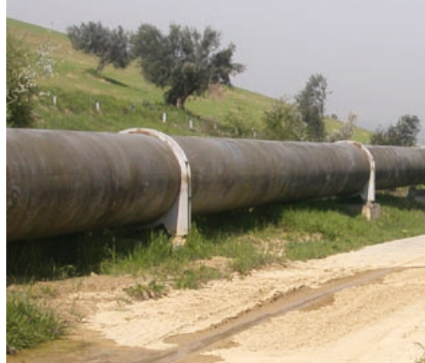
Condotta adduttrice Dn 1400.
